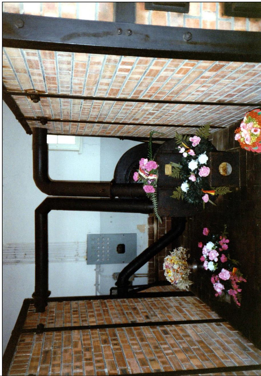
DOKUMENT 14: Topf-Dreimuffelofen im Krematorium des KL Buchenwald; Druckluftanlage zwischen den zwei Öfen. Aus: Mattogno/Deana 2015, Bd. III, Foto 188, S. 121.
