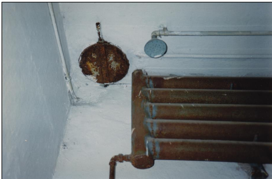
Foto 7: "Gaskammer" von Mauthausen: Deckel der Öffnung des Entlüftungsrohrs und Teil des Heizkörpers. Dezember 1990. © Carlo Mattogno.
