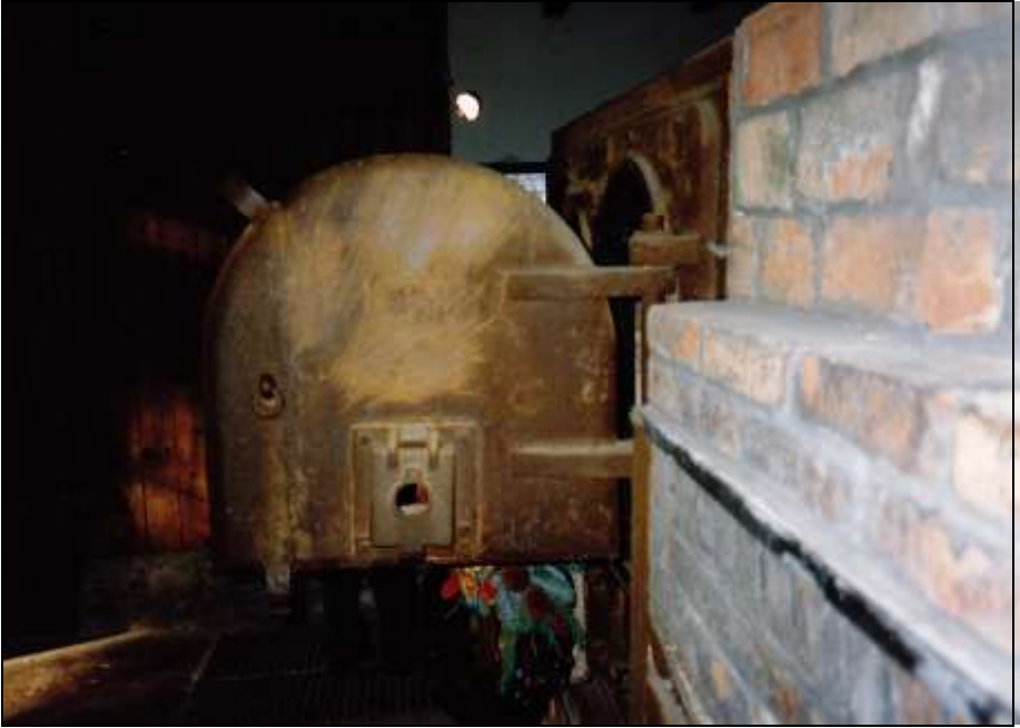
Foto 44: Linke Muffeltür, außen.
