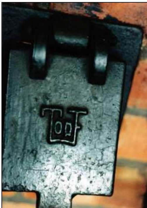
Foto 154: Klappe des Verbrennungsluftkanals mit TOPF-Logo, Nahaufnahme.
