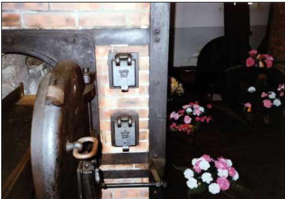
Foto 148: TOPF, koks- oder ölbefuerter Dreimuffel-Kremierofen. Rechte Muffel. Klappen der Verbrennungsluftkanäle der Muffel (oben) und der Aschenkammer (unten).
