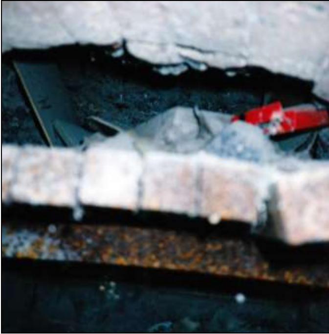
Foto 82: Herdrost des linken Generators (von hinten gesehen).
