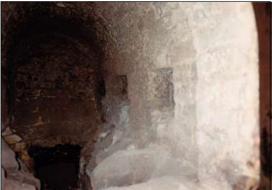
Foto 142; wie zuvor, rechte Wand mit rechteckigen Öffnungen zur Mittelmuffel.
