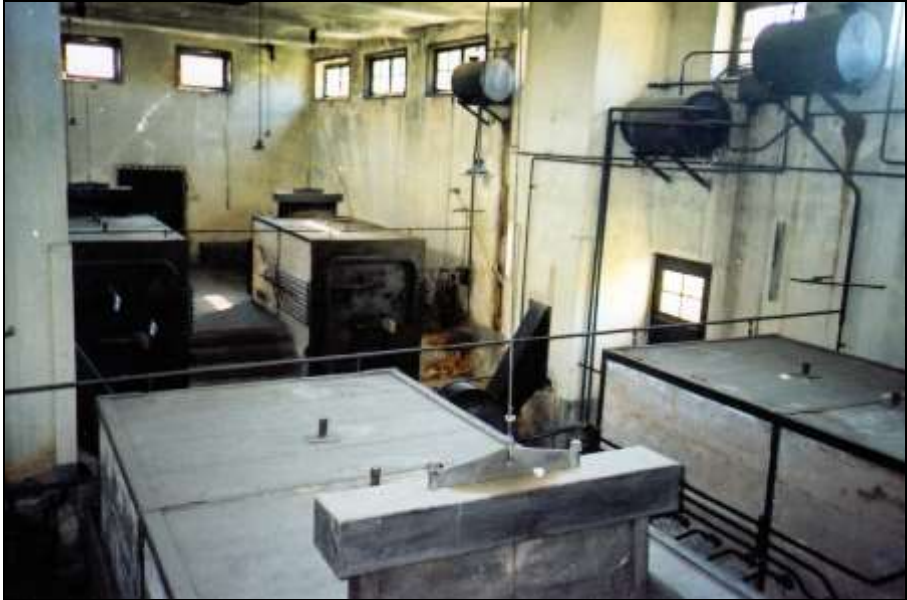
Foto 345: Die vier Öfen von oben betrachtet. Oben an der rechten Wand sind die Öltanks.
