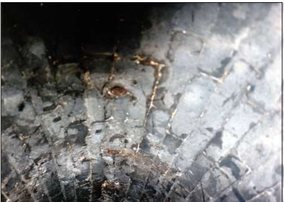
Foto 61: Gewölbte Decke der rechten Muffel; Austritt von Rohren, die an das Gebläse angeschlossen sind.
