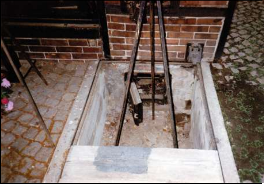
Foto 10: Rechter Generator: Primärluft-Zutrittsöffnung, Aschentür und Wartungsgrube.
