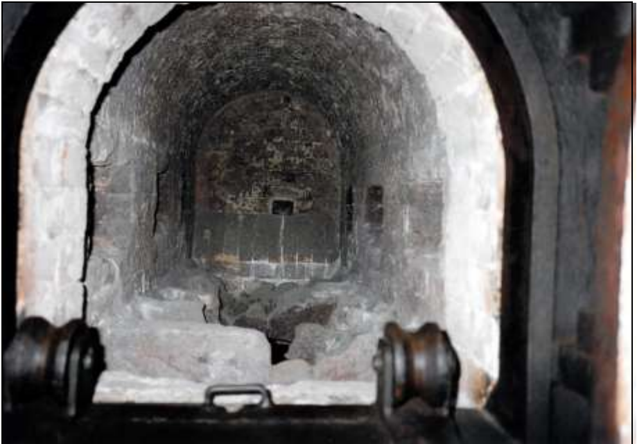
Foto 180: wie zuvor, Blick in die Muffel über die Lauffrollen hinweg.
