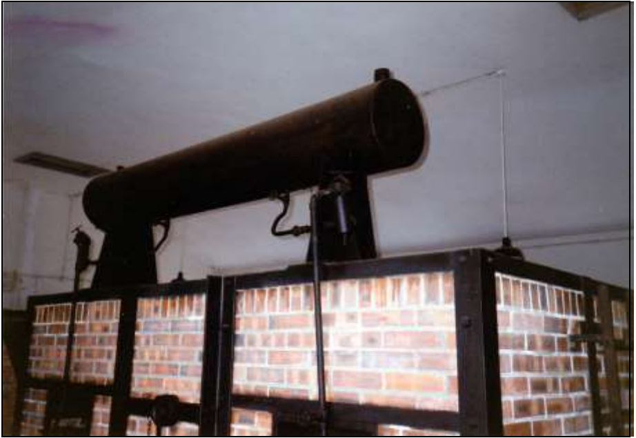
Foto 202: TOPF, koks- oder ölbefuerter Dreimuffel-Kremierungssofen; Öltank, Rückansicht.
