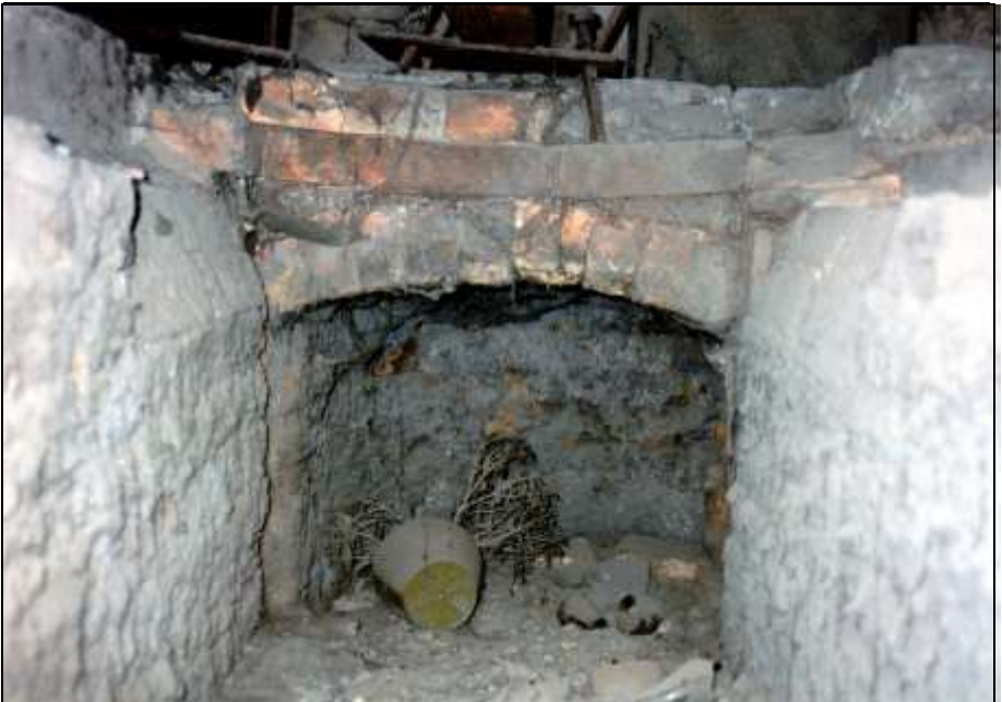
Foto 102: Trümmer des Ofen Nr. 3: Rauchkanalöffnung der linken Muffel.
