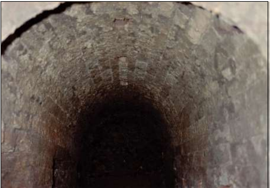
Foto 146: wie zuvor, gewölbte Muffeldecke mit quadratischen Öffnungen für die Verbrennungsluftversorgung.
