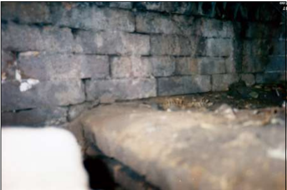
Foto 282: wie zuvor. Die Muffel-Aschenkammer, durch die Aschentür des Hilfsgenerators betrachtet.
