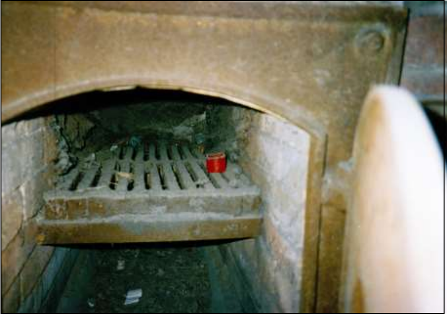
Foto 264: Blick durch die Aschentür des Hauptgenerators auf den Koksrost.
