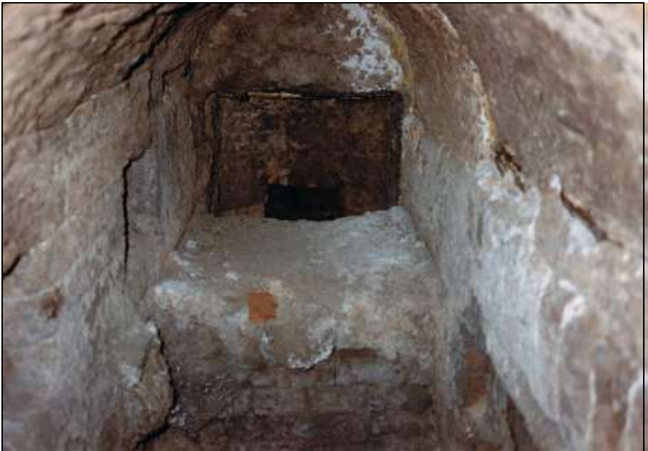
Foto 25: Rechte Muffel: Rückwand mit Rauchgasöffnung.
