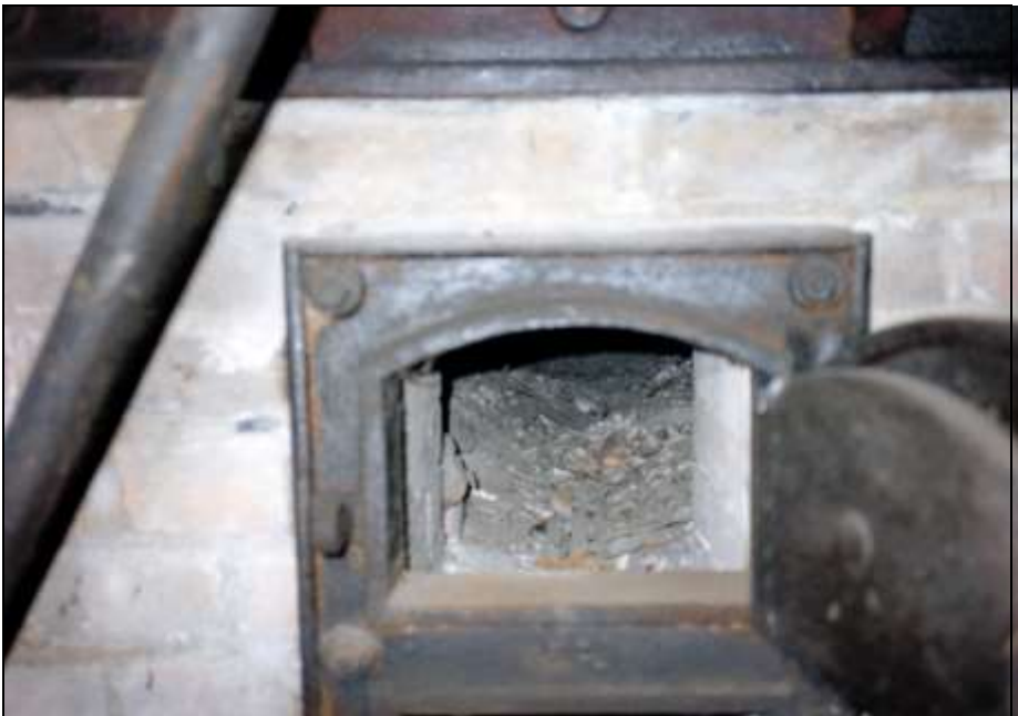
Foto 303: Reinigungstür der Nachbrennkammer.
