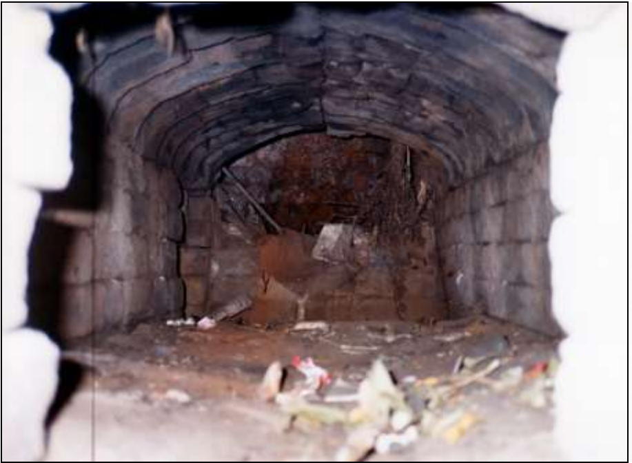
Foto 273: Die Aschenkammer der linken Muffel. Oben: Unterseite der Muffelrostbalken. Linke Wand hinten: Öffnung zum Hilfsherd. Ganz hinten unten: die Generatorgrube.
