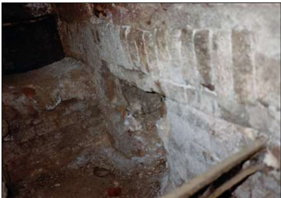
Foto 27: Rechte Muffel: Aschenraum mit der Öffnung, die ihn mit dem Generator verbindet.
