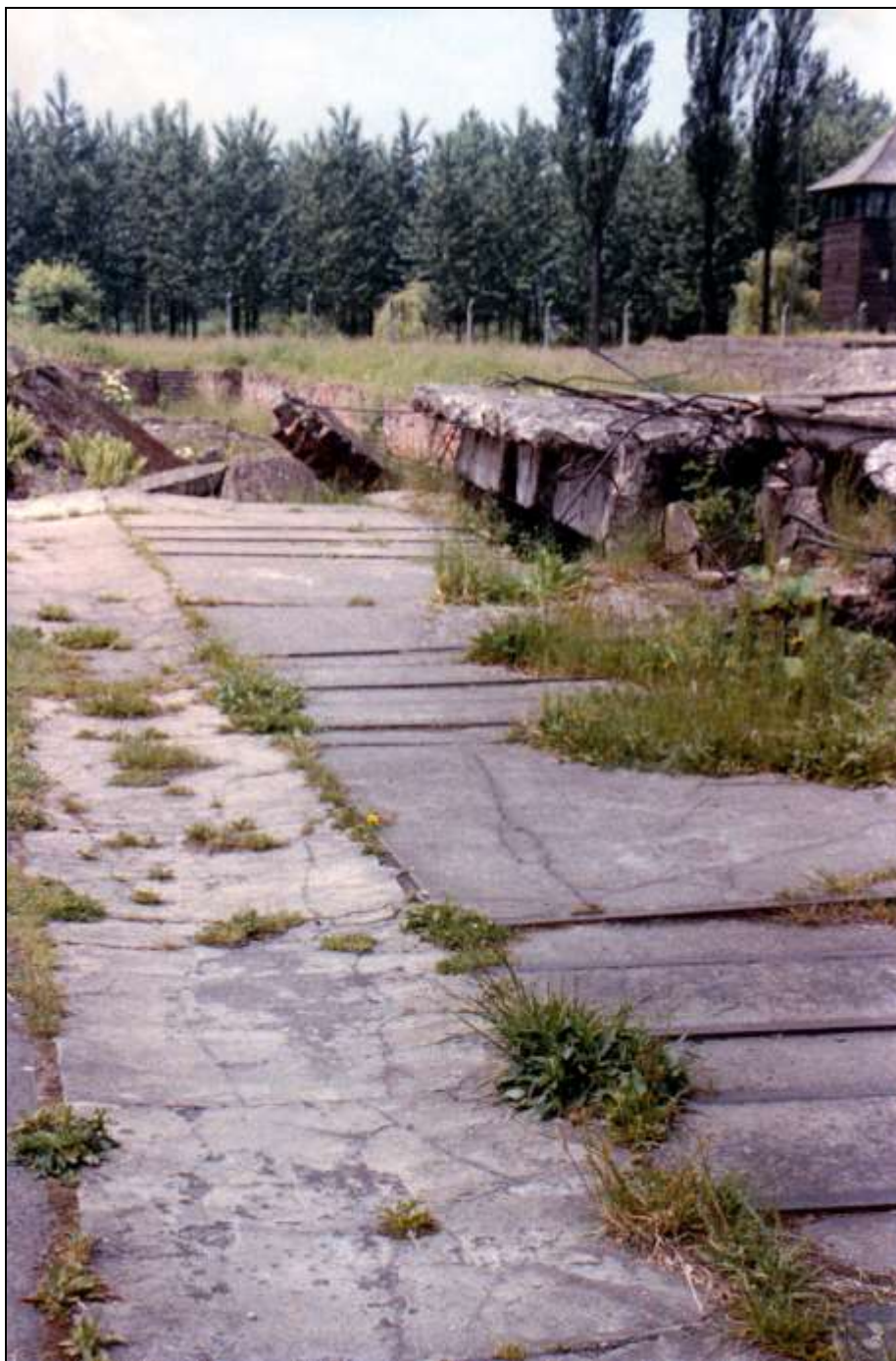
Foto 219: wie Foto 216; Schienen für den Leicheneinführwagen zu den ersten drei Öfen und Lage der Längsschienen für die Drehscheibe (von Ost nach West).
