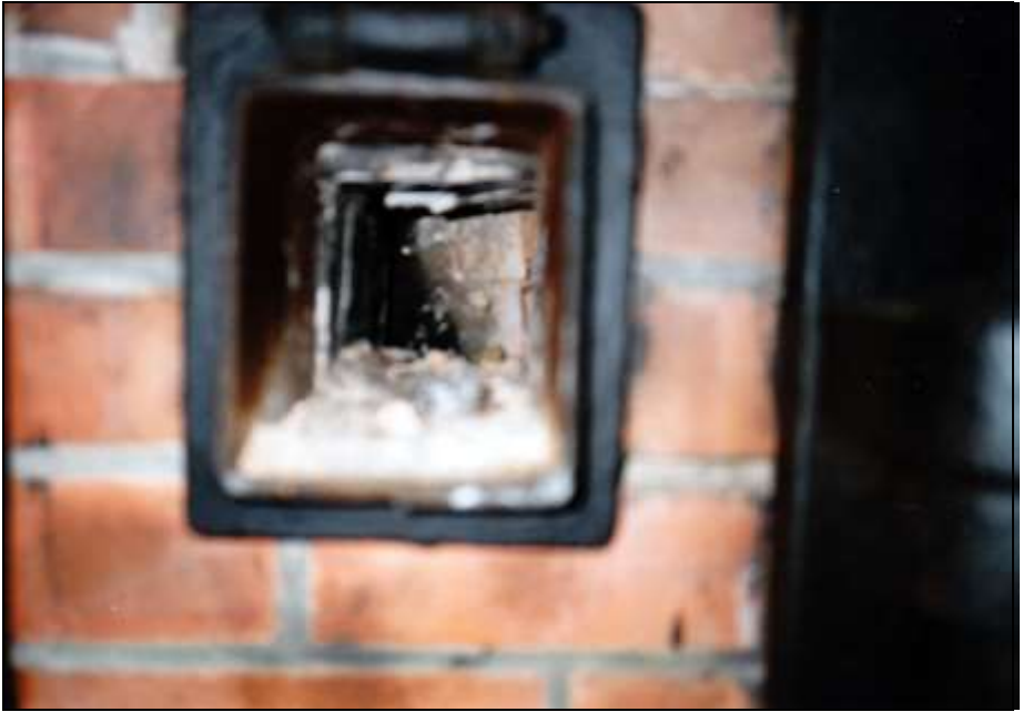
Foto 151: wie zuvor, Verbrennungsluftkanal der Muffel.
