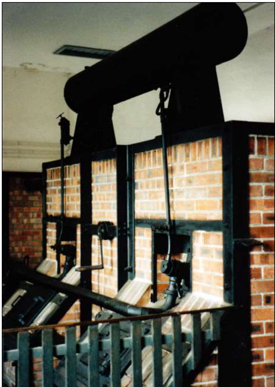
Foto 201: wie zuvor, rechte Rückansicht; Leitungsanschluss an die Ölbrenner.
