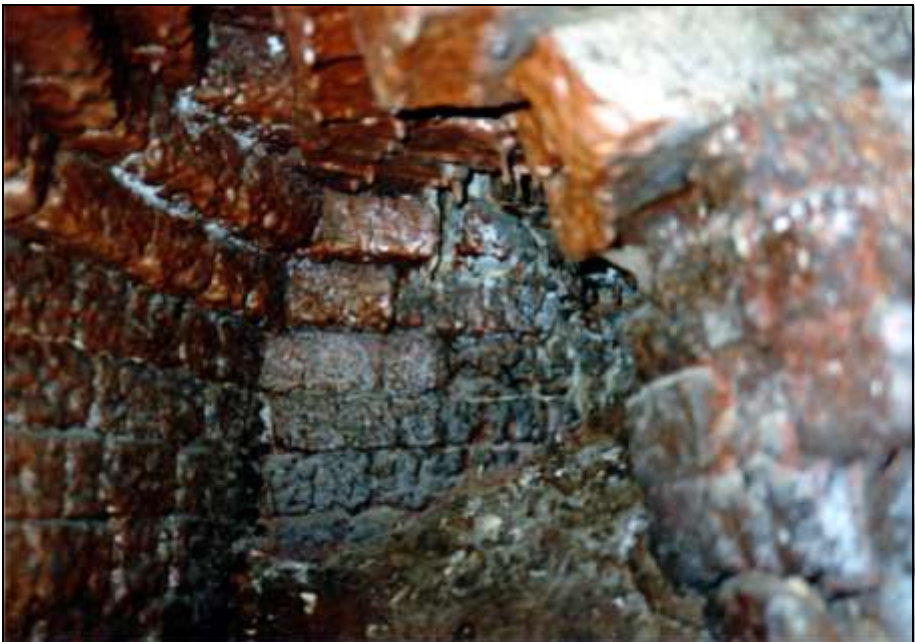
Foto 5: Linker Generator: Innenansicht mit der ersten Öffnung, die ihn mit der linken Muffel verbindet. Das Schamottmauerwerk zeigt deutliche Sinter Spuren. (Für zwei weitere ähnliche Aufnahmen siehe die erst später platzierten Fotos 315f.)
