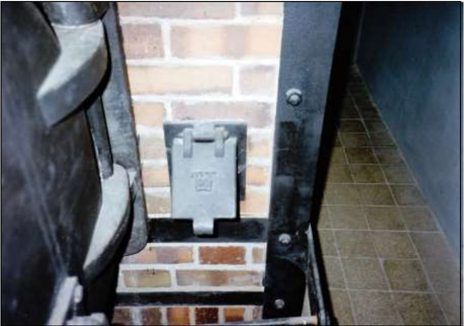
Foto 59: Klappe des Verbrennungsluftkanals der rechten Muffel.
