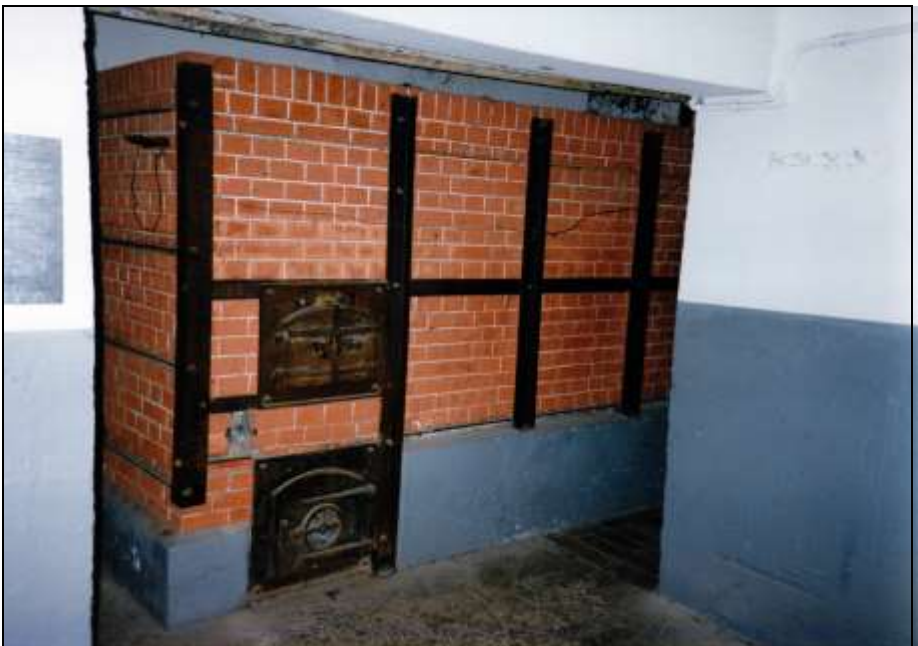
Foto 245: linke Seitenansicht; Koksfülltür des Generators (oben) und Aschentür (unten).
