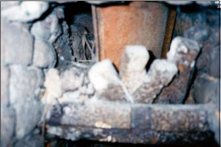
Foto 277: Das Innere des Hauptgenerators des rechten Ofens, durch die Aschentür betrachtet. Der Feuerungsrost ist beschädigt; nur noch vier Vierkanteisen sind am äußeren Auflagereisen lediglich angelehnt.
