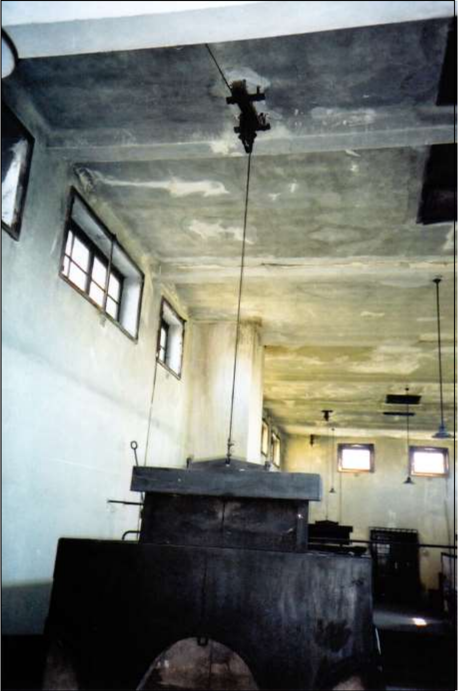
Foto 360: linker Ofen des vorderen Paares, Vorderansicht; Drahtseil des Muffelabsperrschiebers mit an der Decke befestigten Umlenkrollen.
