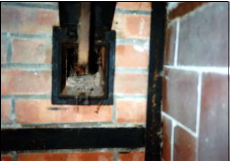
Foto 166: wie zuvor, Nahaufnahme des Verbrennungsluftkanals zum Generator.
