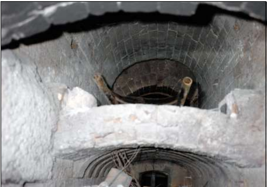
Foto 314: wie zuvor; unten: die Aschenkammer mit der Aschenentnahmetür im Hintergrund; darüber: Schamottrost der Muffel; oben: die Muffel.
