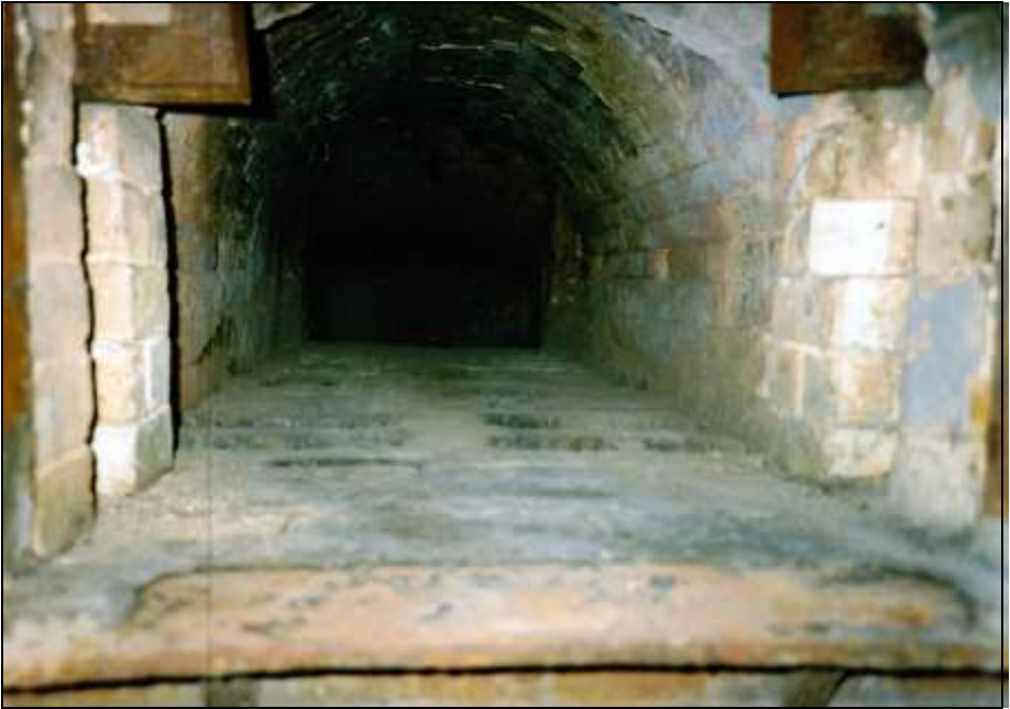
Foto 268: wie zuvor, Nahaufnahme der Muffel mit Muffelrost.
