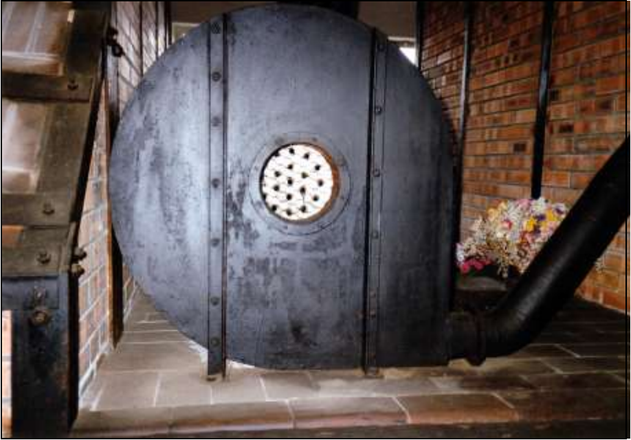
Foto 195: Verbrennungsluftgebläse für den Ölbrenner des öl- bzw. koksbeheizten Ofens. Rückansicht.
