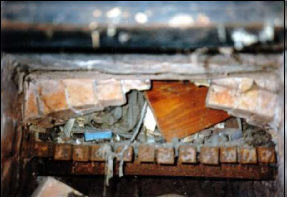
Foto 177; wie zuvor; Blick in die Aschenkammer des Generators mit Rost.
