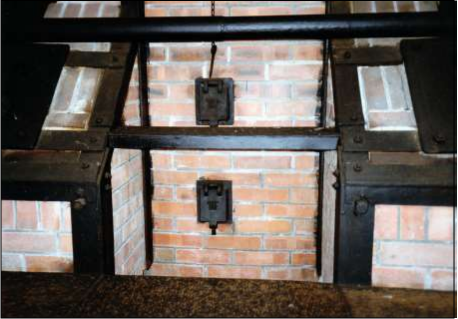
Foto 169: wie zuvor; Klappe des Verbrennungsluftkanals zur Muffel (oben) und zur Aschenkammer (unten).
