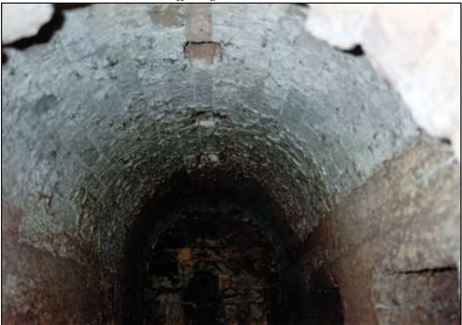
Foto 132: wie zuvor; entlang der Scheitellinie der gewölbten Decke befinden sich vier quadratische Öffnungen mit Rohröffnungen, durch die Verbrennungsluft in die Muffel geleitet wurde.
