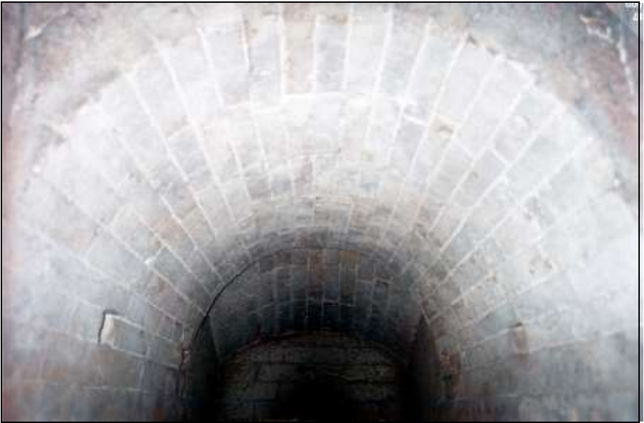
Foto 297: Gewölbte Decke der ersten Muffel; an den Seitenwänden sind die Öffnungen der Verbrennungsluftkanäle zu sehen.
