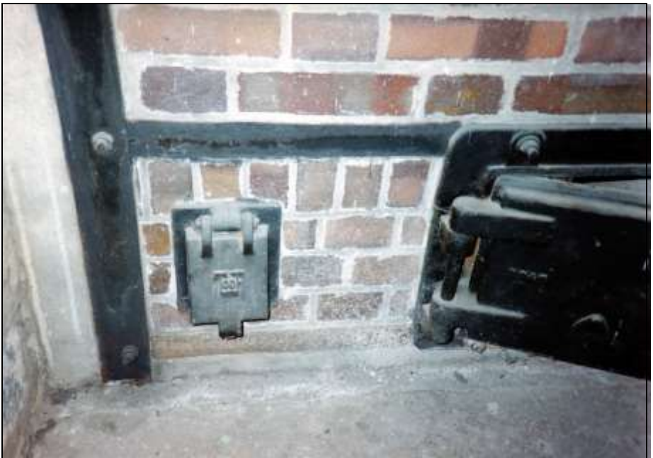
Foto 81: wie zuvor; linker Verbrennungsluftklappe.
