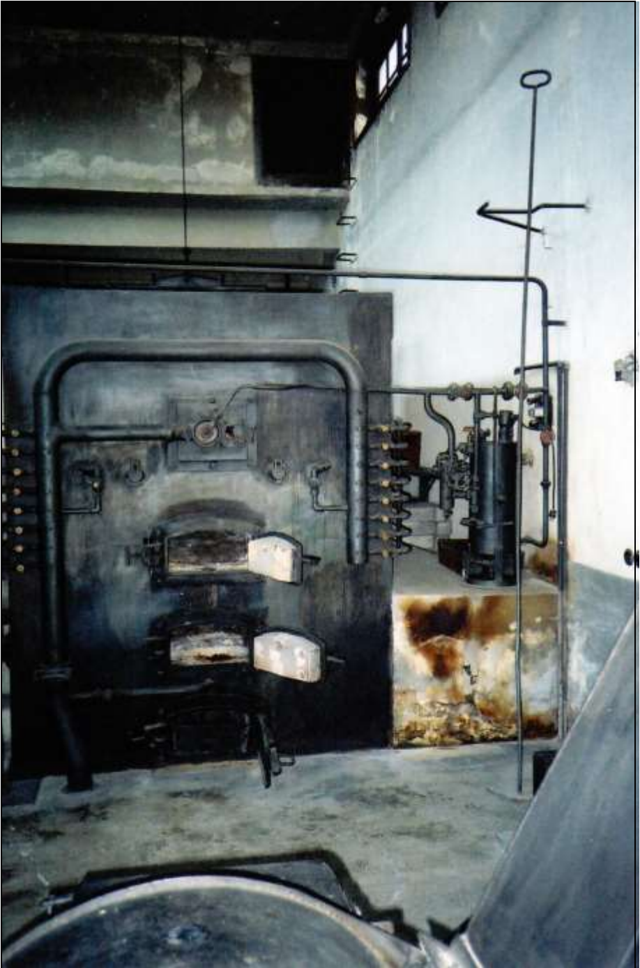
Foto 349: wie zuvor; rechts neben der Wand befindet sich der Ölvorwärmer hinter dem langen Kratzer.
