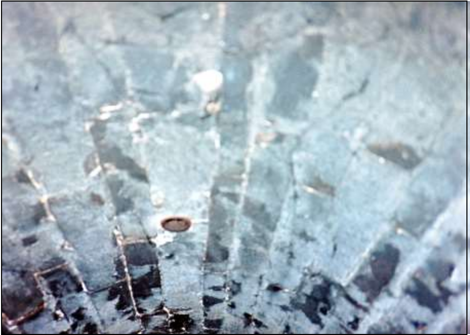
Foto 60: Gewölbte Decke der linken Muffel; Austritt von Rohren, die an das Gebläse angeschlossen sind.
