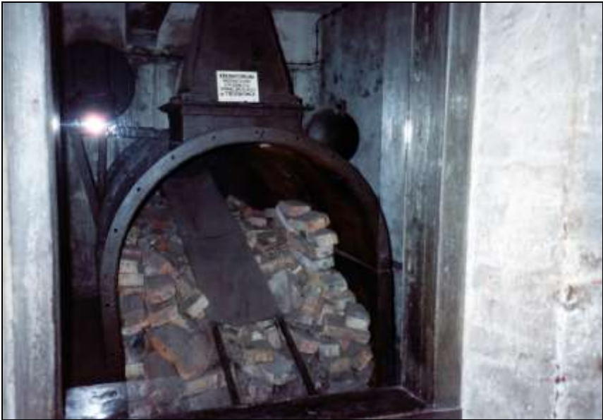
Foto 330: Vorderansicht des Ofens. Das Ofeninnere wurde völlig zerstört. Oben der konische Schornstein (Mitte), das Gebläse (links) und der Öltank (rechts).
