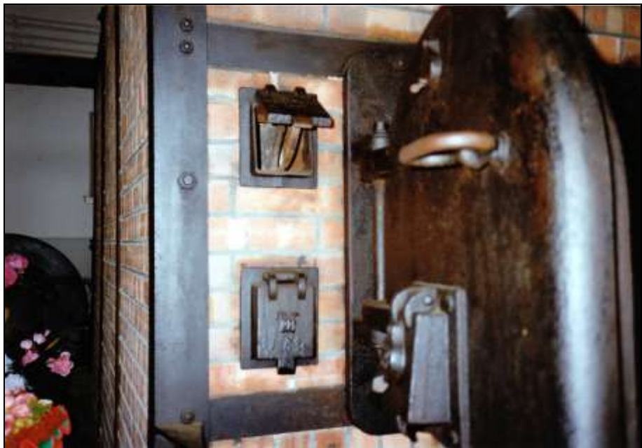
Foto 153: wie zuvor, beide Klappen der Verbrennungsluftkanäle.
