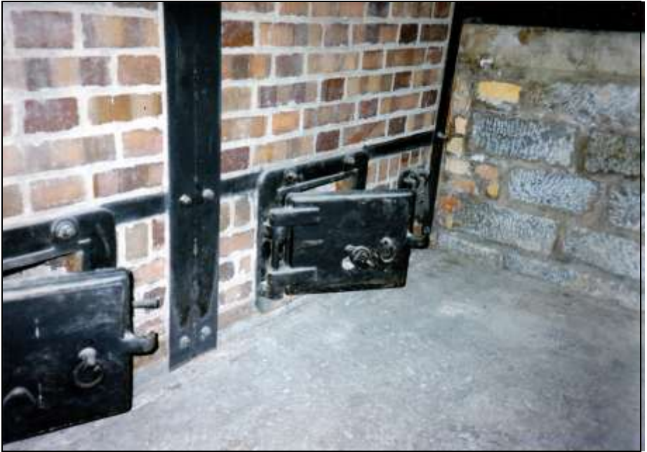
Foto 80: wie zuvor, Aschentüren der Generatoren.
