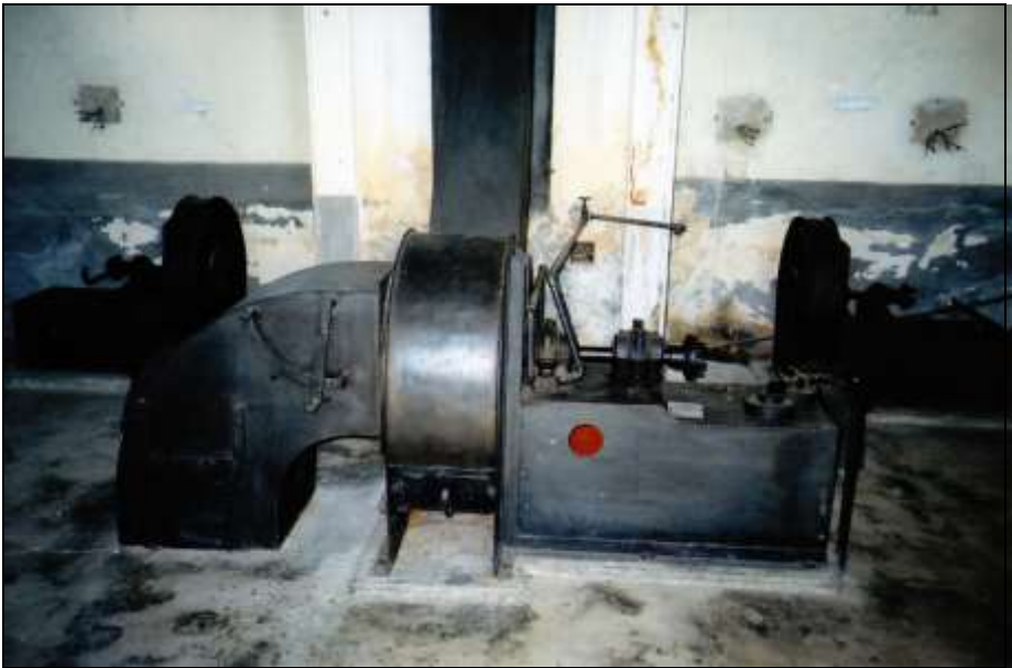
Foto 356: Saugzuggebläse des vorderen Ofenpaars, mit Saugkanal (links), Kaminkanal (Mitte) und Motor (rechts). Im Hintergrund links und rechts die zwei Verbrennungsluftgebläse.
