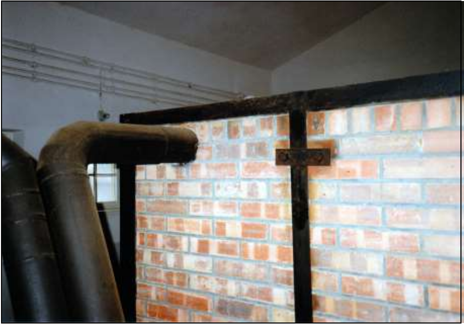
Foto 193: In den koksbefeuerten Ofen mündende Druckluftleitung.
