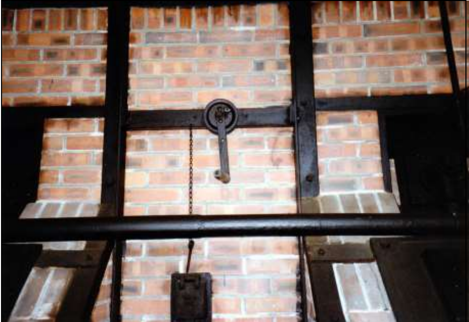
Foto 168: wie zuvor, mittlere Muffel. Handwinde zur Betätigung des Rauchkanalschiebers (oben) sowie die Klappe zum hinteren Verbrennungslufikanal dieser Muffel (unten).
