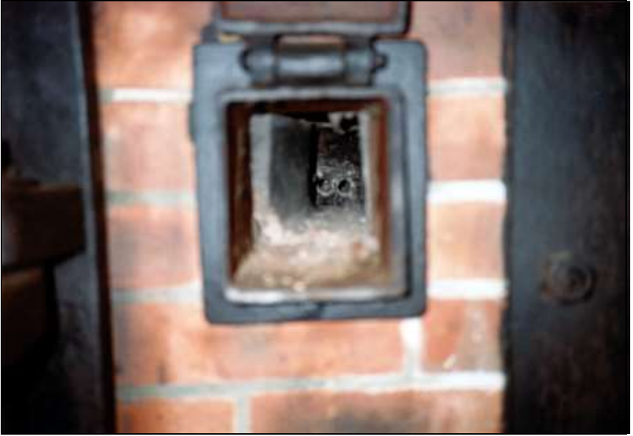
Foto 149: wie zuvor, Verbrennungsluftkanal der Muffel.
