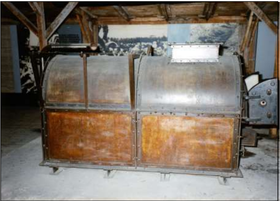
Foto 325: wie zuvor. Am hinteren Ende oben auf dem Ofen sieht man die Verbrennungsluftleitung für den Ölbrenner (links), das Stützgerüst für das Gebläse und den Motor (Mitte), und den Austritt des Kamins (rechts).
