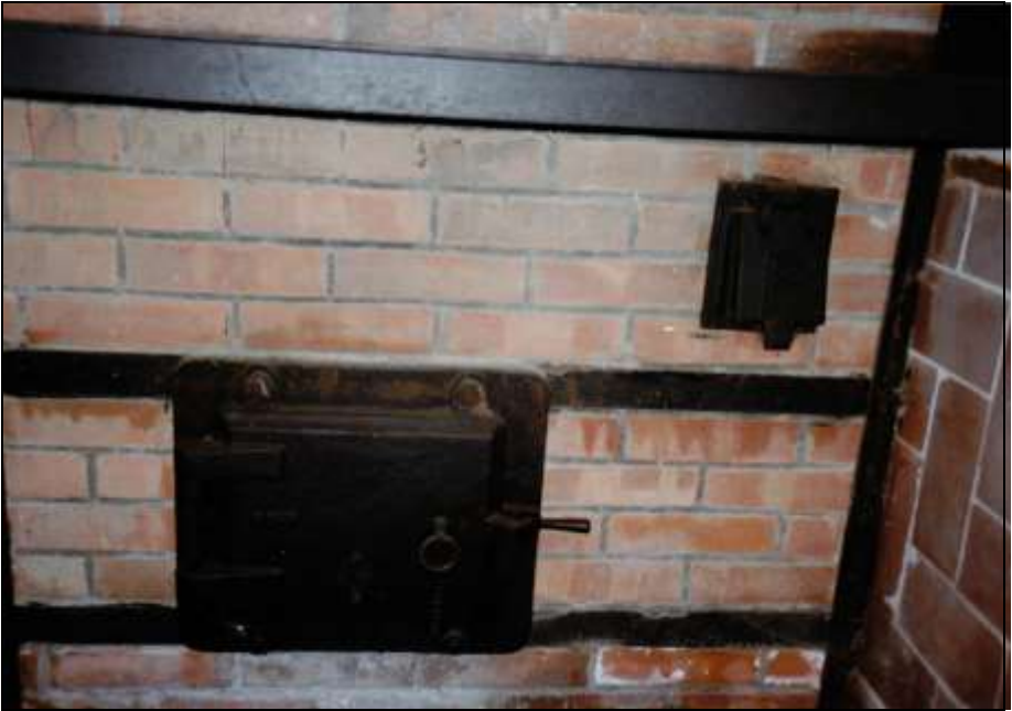
Foto 165: wie zuvor; Aschentür des Generators (unten) und Klappe des Verbrennungsluftkanals zum Generator (oben rechts).
