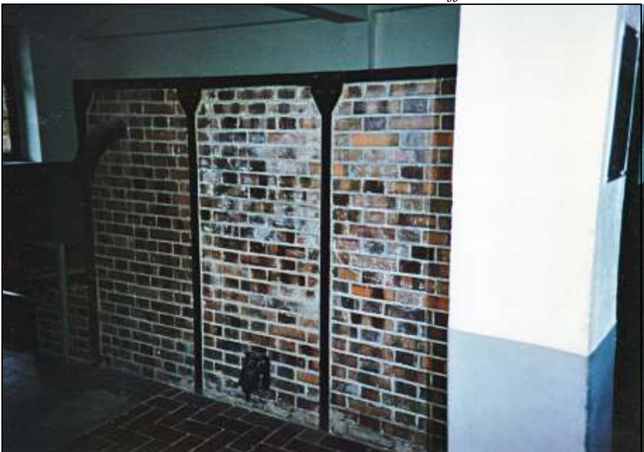
Foto 73: Linke Seite des Ofens: Verbrennungsluftklappe, deren Kanal in die Aschenkammer der linken Muffel führt.
