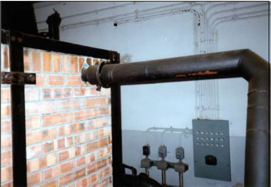
Foto 192: In den öl- bzw. koksbefeuerten Ofen mündende Druckluftleitung. Am Ende des Rohrs, nahe der Ofenwand, befindet sich eine Drosselklappe zur Regulierung des Luftstroms.
