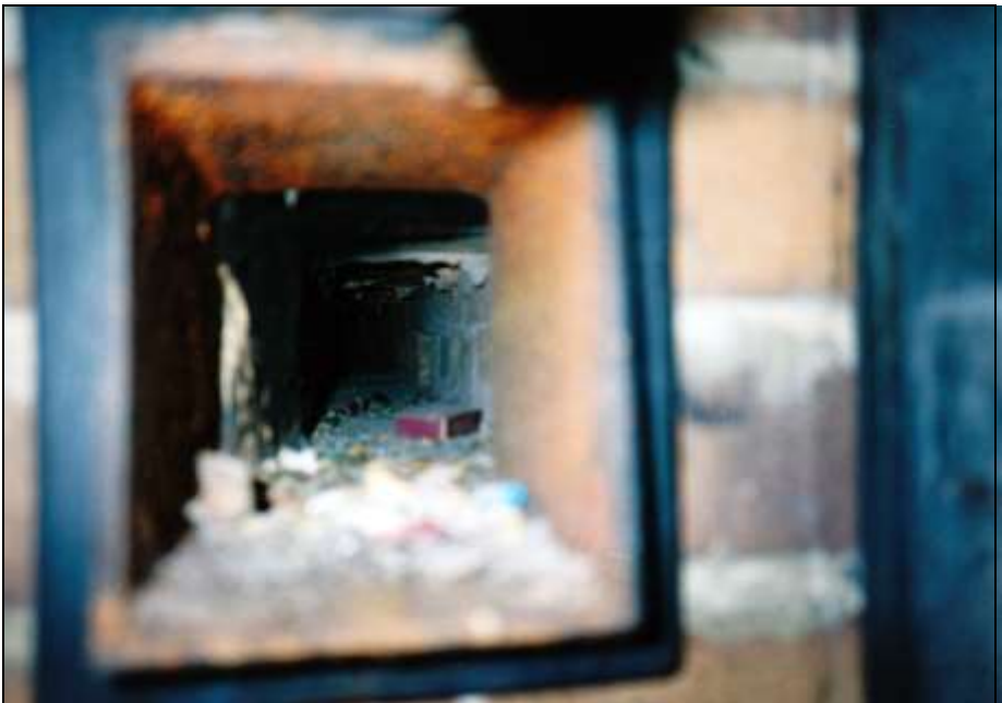
Foto 57: Verbrennungsluftkanal der linken Muffel, verschlossen mit der im nächsten Bild sichtbaren Klappe.
