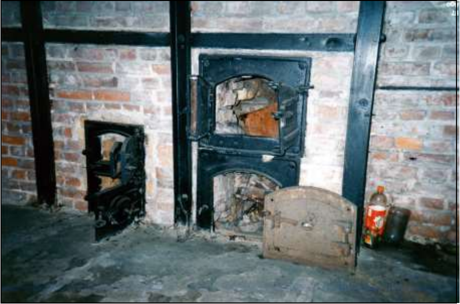
Foto 276: Rechter Ofen. Links: Koksfülltür (Mitte) und Aschentür (unten) des Hilfsgenerators. Mitte: doppelflüglige Koksfülltür des Hauptgenerators mit der Aschentür darunter.
