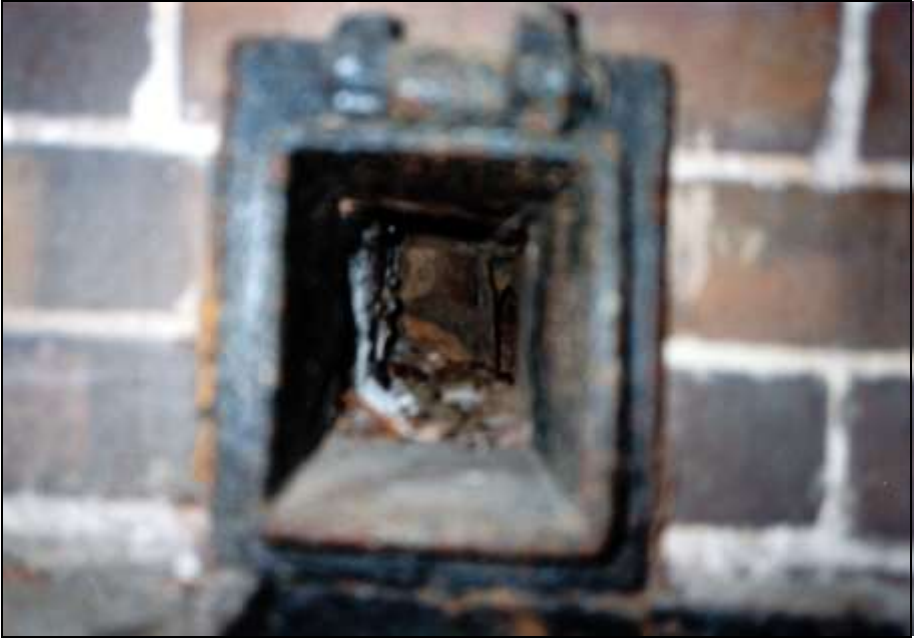
Foto 6: Linker Generator: Primärluft-Zutrittsöffnung.
