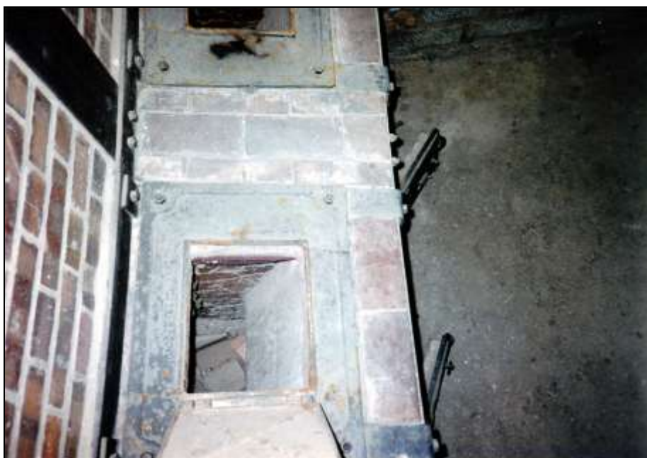
Foto 79: wie zuvor; Generatorfüllschachtverschluss des Generators der rechten Muffel.
