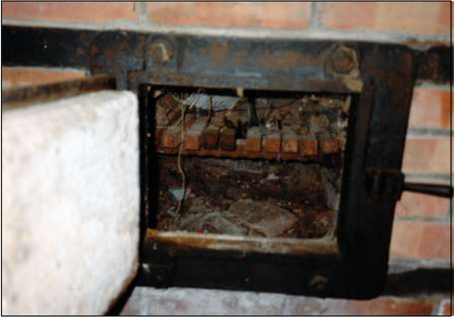
Foto 167: wie zuvor, Blick in die Aschenkammer des Generators samt Rost.
