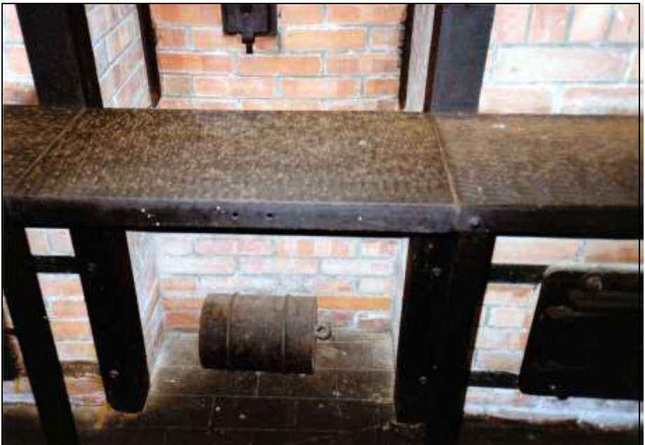
Foto 172: wie zuvor; Zementgegengewicht für den Rauchkanalschieber.
