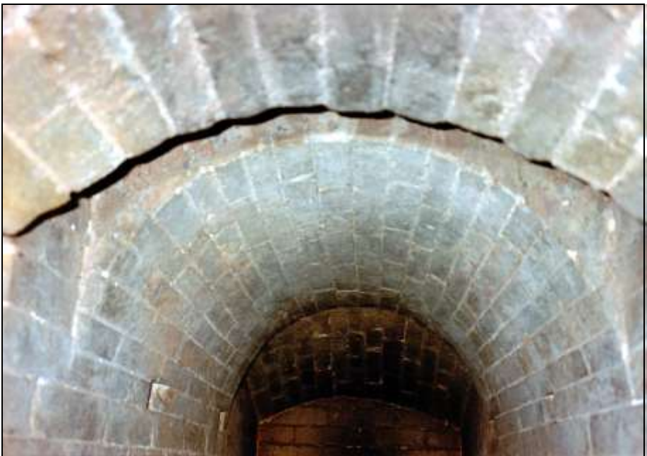
Foto 321: wie zuvor; die gewölbte Muffeldecke mit der Abgaskanalöffnung im Vordergrund.
