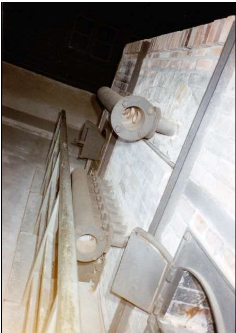
Foto 308: wie zuvor. Heißwasserrohre des Rekuperators.
