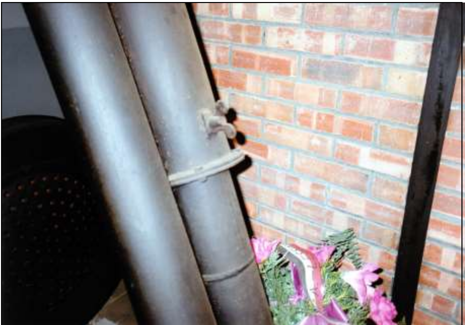
Foto 194: Druckluftleitung mit Verbrennungsluft zu den Öfen; Drosselklappe in der rechten Leitung zur Regulierung des Luftstroms.
