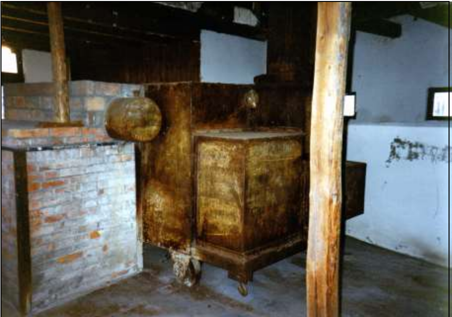
Foto 45: Rückseite des Ofens, rechte Seite. Über dem Generator ragt das hintere Ende des Öltanks hervor, der eingemauert wurde. Der ursprüngliche Ofenkörper ruht auf Rädern.
