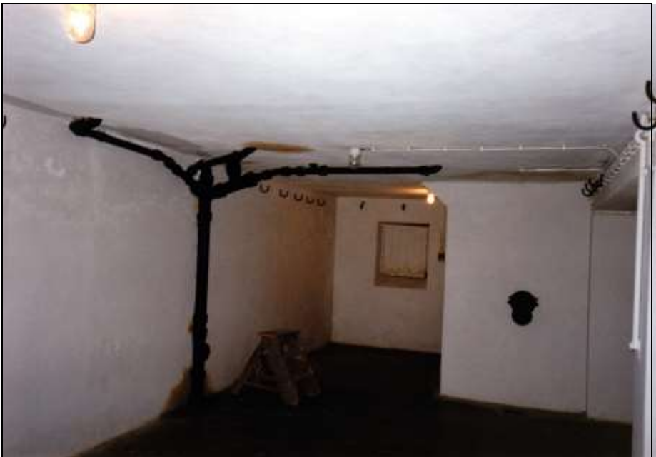
Foto 211: wie zuvor; an der Rückwand, rechts, die manuellen Bedienelemente für den Betrieb des Lastenaufzugs.
