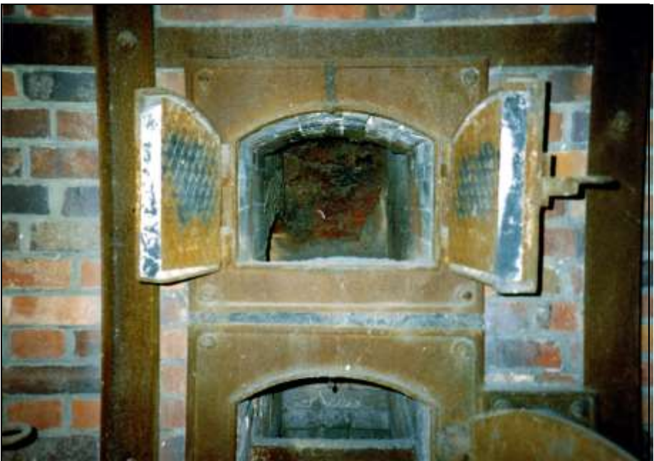
Foto 261: Koksfülltür des Hauptgenerators.
