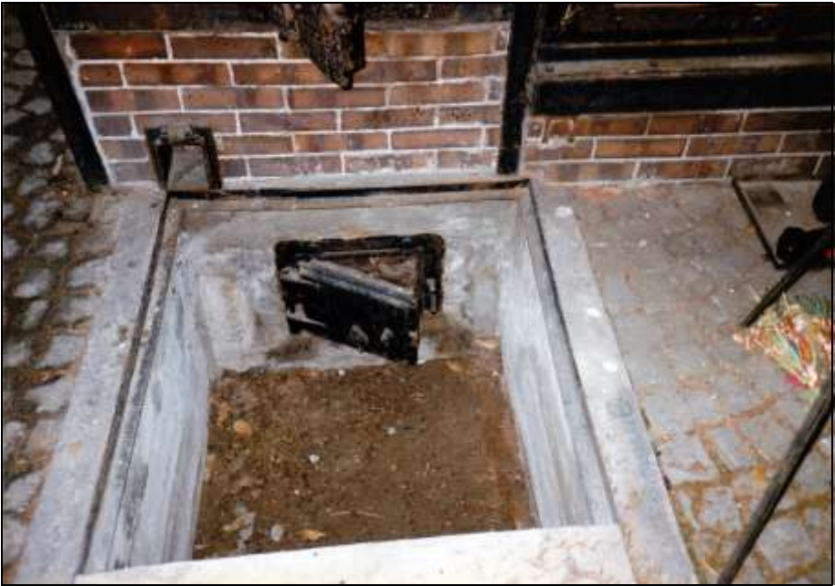
Foto 7: Linker Generator: Schlacken-/Aschentiür und Wartungsgrube.
