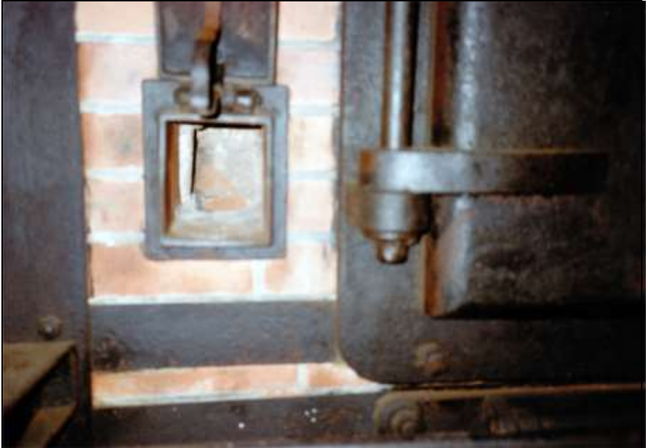
Foto 152: wie zuvor, Verbrennungsluftkanal der Aschenkammer.
