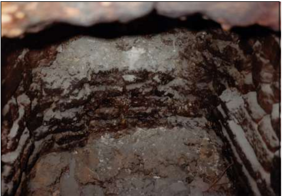
Foto 164: wie zuvor; Inneres des Generators. Das Mauerwerk zeigt Sinterspuren.
