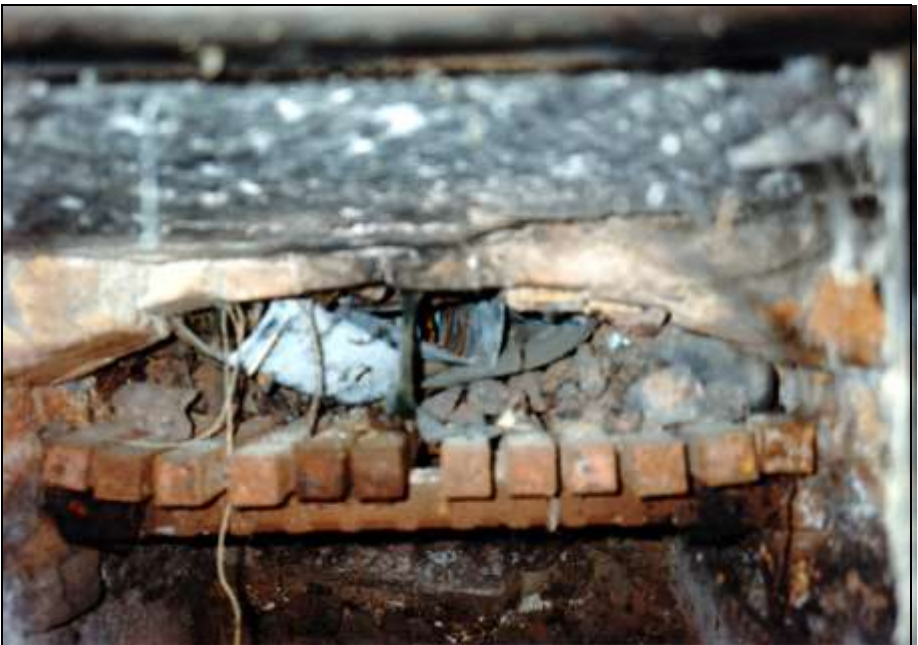
Foto 174: wie zuvor; Blick in die Aschenkammer des Generators mit Rost.
