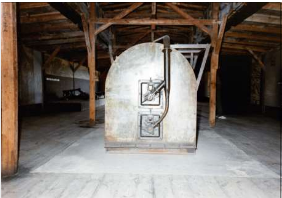
Foto 327; Rückansicht; Verbrennungsluftleitung mit Haupt- (Mitte) und Hilfsbrenner (unten).
