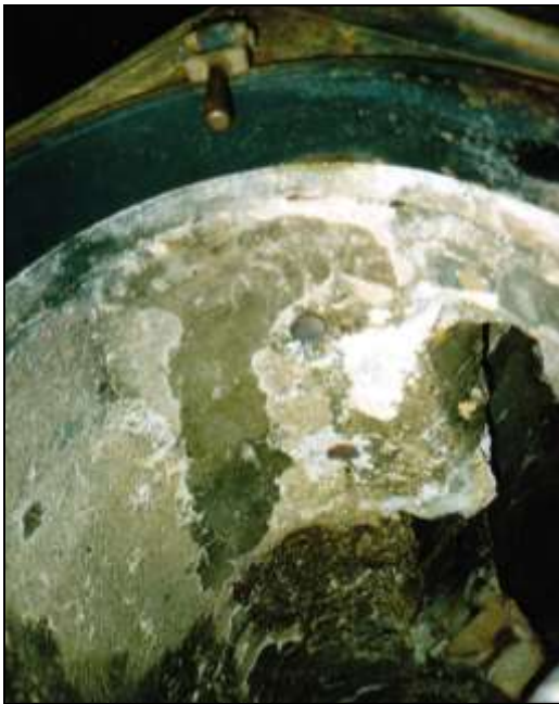
Foto 41: Gewölbte Decke der linken Muffel; rechts: Austritt von Rohren, die an das Gebläse angeschlossen sind.
