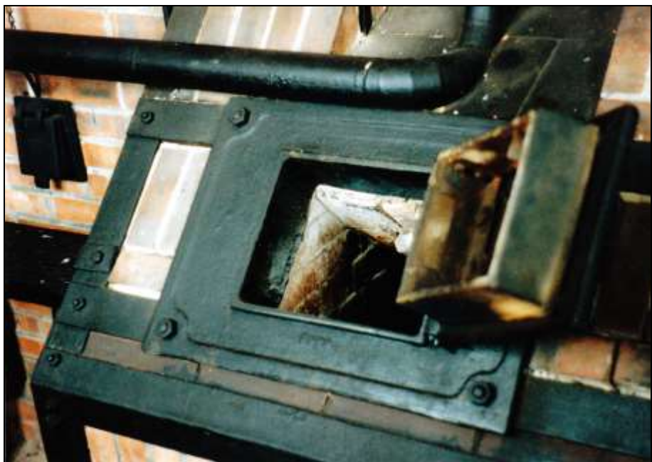
Foto 162: wie zuvor, mit geöffnetem Generatorfüllschachtverschluss.
