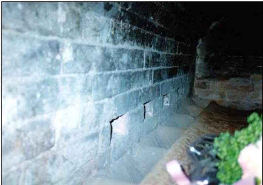
Foto 54: Linke Muffel mit vier Zutrittslöchern für die Verbrennungsluft.
