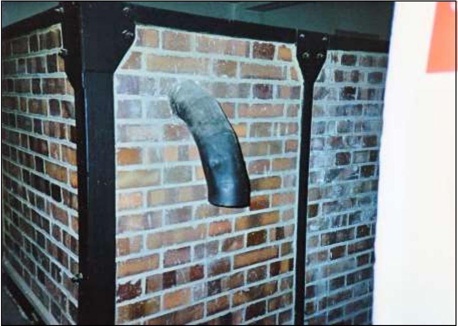
Foto 76: Ursprünglich an ein Gebläse angeschlossene Luftleitung.
