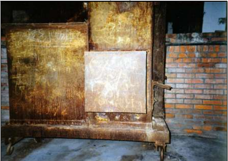
Foto 47: Rückseite des Ofens; Kaminboden mit offener Reinigungsklappe an der rechten Seite. Das am Schornsteinboden angeschweißte quadratische Blech verschließt die Öffnung für das ursprüngliche Saugzuggebläse.
