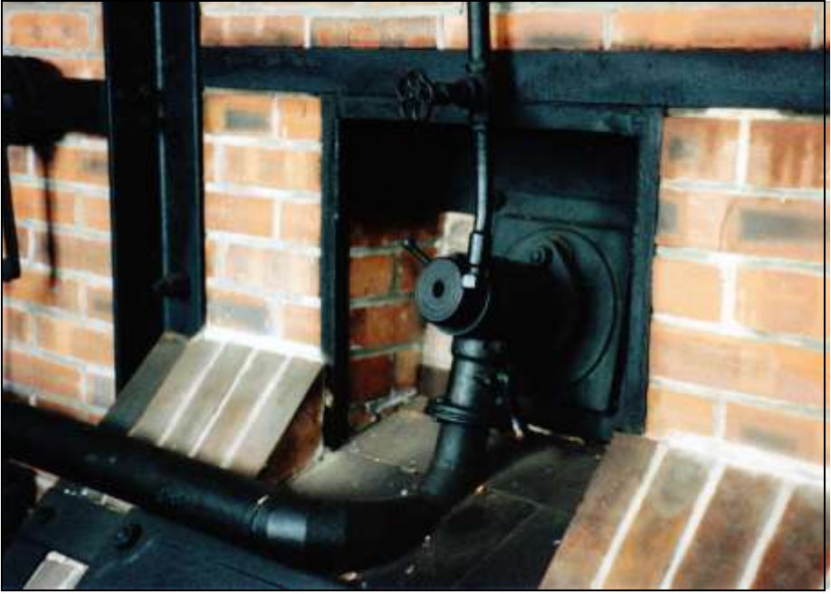
Foto 204: wie zuvor, Rückansicht, Ölbrenner der linken Muffel. Von oben an den Ölbrenner angeschlossen ist die Leitung, durch die das Öl aus dem Öltank fließt, und von unten die Leitung vom Verbrennungsluftgebläse.
