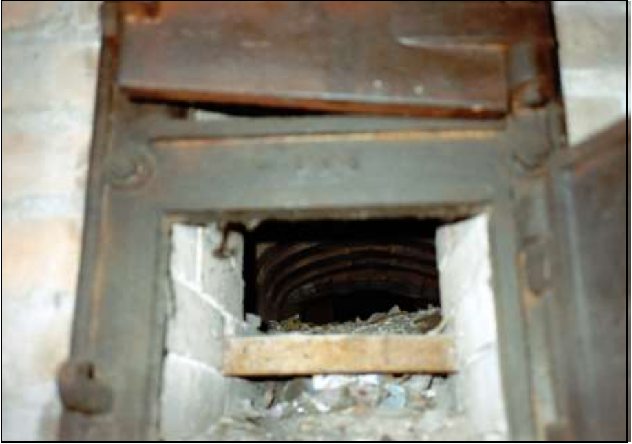
Foto 304: Aschenentnahmetür mit erstem Balken des Nachbrennrostes.
