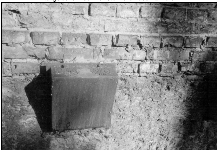
Foto 31: Block 11, außen, Südost-Mauer, einer der Eisenblechkästen über Lüftungslöchern der vier Stehzellen des Bunkers.
