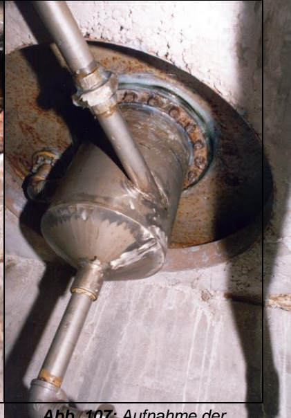
Abb. 107: Aufnahme der Rohrleitungen aus rostfreiem Stahl und des Chemiebehälters unter dem Sitz der Gaskammer.
