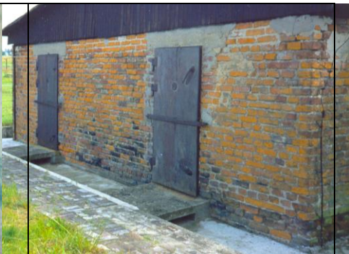
Abbildung 43: Blauverfärbung der Zyklon-B-Entwesungsanlage, Kammern II und III (Außenwand), von Baracke 41 im KL Majdanek. (© Carlo Mattogno 226 )
