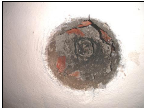
Abb. 52: Fehlender falscher Duschkopf in der Decke der angeblichen Gaskammer im KL Dachau. Dadurch sichtbar der mit Ziegelsteinbrocken versetzte Beton.
