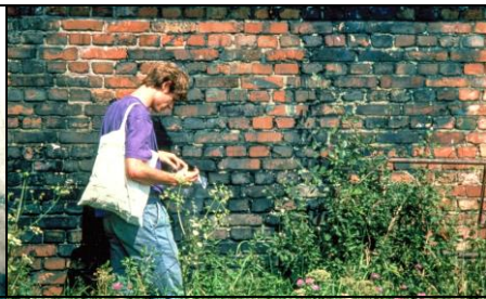
Abbildung 39: Außenmauer Südwest des Zyklon-B-Entlausungstraktes des Bauwerkes BW 5b im KL Auschwitz-Birkenau. (© Karl Philipp 223 )
