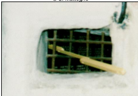
Abb. 34: Öffnung mit Gitter in der Wand von Raum I im Entwesungstrakt von Gebäude 41, Majdanek (siehe Abb. 32)
