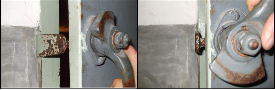
Abb. 60a & b: Heute können die Türen zur angeblichen Gaskammer in Dachau nicht geschlossen werden: der fehlende Schließmechanismus und an den Rahmen geschweißte Stahlstifte verhindern dies.
