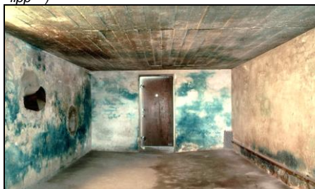
Abbildung 40: Blauverfärbung der Zyklon-B-Entwesungsanlage, Kammer III (Südwand), der Baracke 41 im KL Majdanek. (© C. Mattogno 224 )
