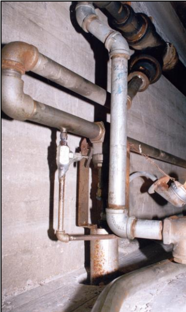
Abb. 108: Teil der Rohrleitungen und des Abflusssystem, das den Chemikalienraum mit der Gaskammer verbindet.
