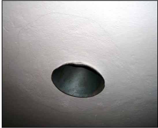
Abb. 53: Falscher Duschkopf in der Decke der angeblichen Gaskammer von Dachau mit Spuren einer Bearbeitung des umliegenden Betons.
