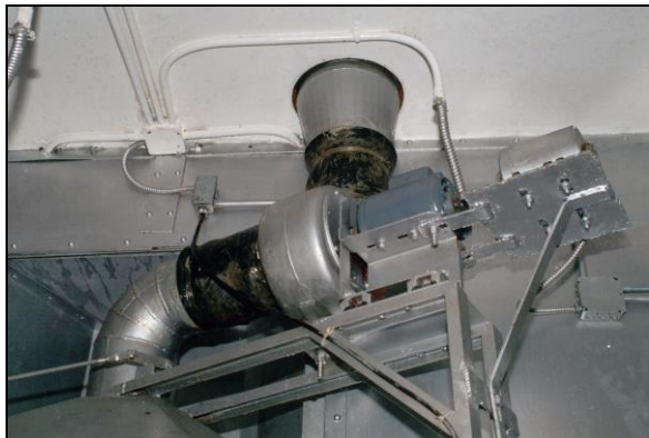
Abb. 102: Abluftgebläse über der Gaskammer.
