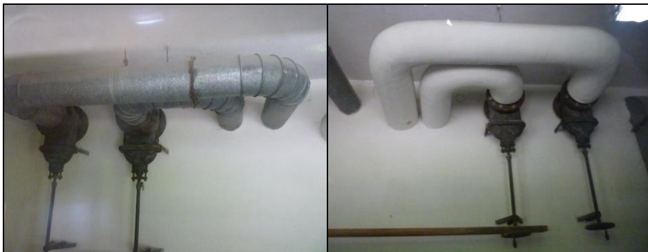
Abb. 24: Dicke Rohrleitungen im Raum hinter und über der Dachauer "Gaskammer."
