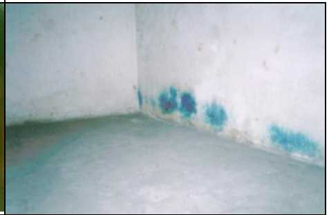
Abb. 90: Zyklon-B-Entwesungsanlage, Kammer II (Westwand), der Baracke 41 im KL Majdanek. (© C. Mattogno)
