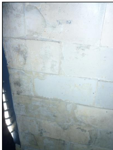
Abb. 23: Neu eingefügte Fliesen bzw. nachgemachte Mörtel- "Fliesen" um die Einwurfschächte.
