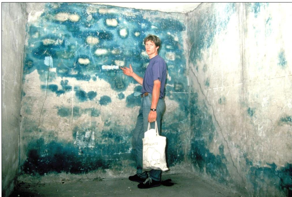
Abbildung 146: Nordwestlicher Raum des Entwesungsflügels von Bauwerk 5a (Raum 4 in Abbildung 41) mit dem Autor. Im Hintergrund und rechts im Bild die Außenmauer mit der intensiven Blaufärbung durch das Eisenblau. Die Probenentnahmestellen der Proben 9 und 11 sind zu erkennen. Links im Bild die Innenmauer, die mit dem Umbau zur Heißluftentwesungskammer eingezogen wurde. Von ihr wurde die Probe Nr. 10 genommen, mit leicht positivem Cyanid-Befund.
