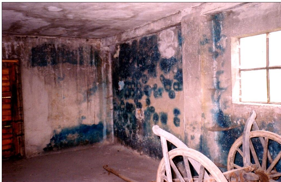
Abbildung 157: Entwesungstrakt des Bauwerks 5a, mit südlicher Außenmauer links und der Westmauer rechts (Raum 3 in Abbildung 41). (© C. Mattogno 1992)
