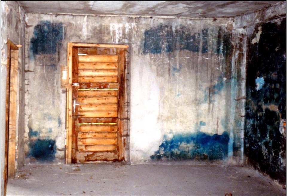
Abbildung 155: Entwesungstrakt des Bauwerks 5a, mit südlicher Außenmauer im Hintergrund und der Westmauer rechts (Raum 3 in Abbildung 41). (© C. Mattogno 1992)
