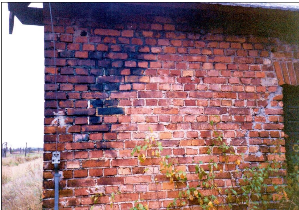
Abbildung 169: Entwesungstrakt des Bauwerks 5a, Südwand mit leichter Verfärbung an der Ecke. (© C. Mattogno 1991)
