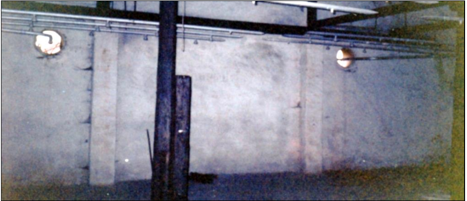
Abbildung 150: Innenaufnahme der Ostwand des Entwesungstrakts von Bauwerk 5b mit nur geringer Verfärbung des kalkreichen, eisenarmen Verputzes.
