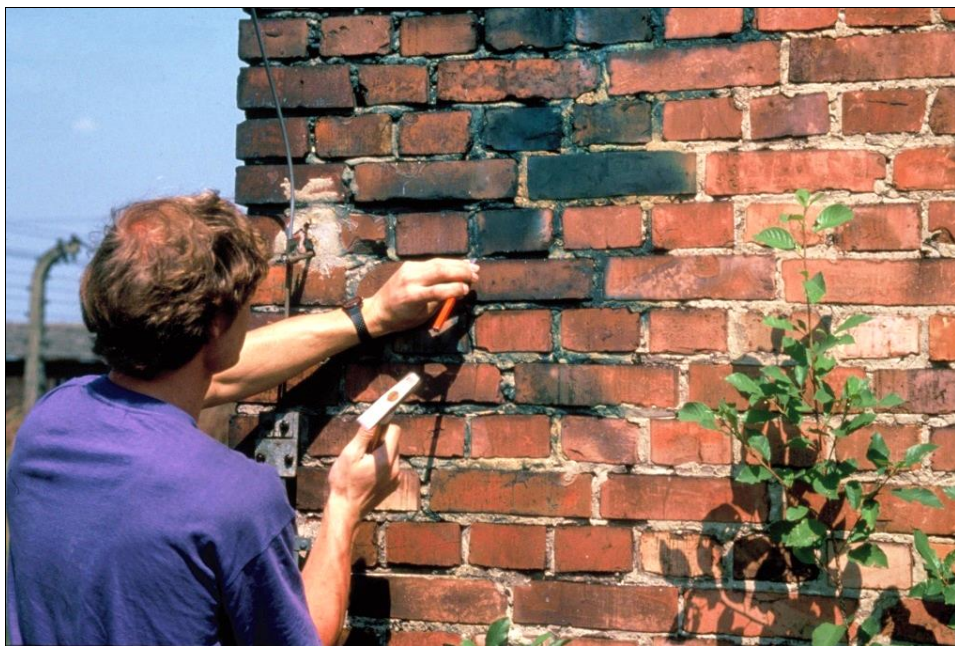
Abbildung 145: Die südliche Außenwand des Blausäure-Entwesungsflügels des Bauwerks 5a im August 1991 mit dem Autor. Geringe Mengen an Cyanid, die durch die Mauer diffundierten, färben die Wand bis heute stellenweise blau. 50 Jahre widrigste Witterungsverhältnisse taten dem keinen Abbruch.
