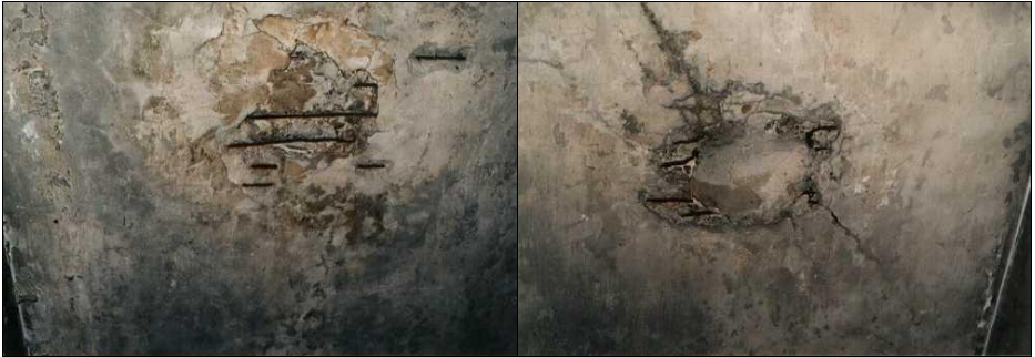
Abbildungen 52 und 53: Zwei der vier vormaligen, innen an der Decke sichtbaren Öffnungen durch das Flachdach der Leichenhalle von Krematorium I im Stammlager Auschwitz. Sie dienten wahrscheinlich als Lüftungsöffnungen des Luftschutzbunkers von 1944. Sie wurden nach dem Krieg aus "musealen Gründen" verschlossen, da sie aufgrund ihrer Lage nicht als Zyklon-B-Einwurföcher hätten dienen können.
