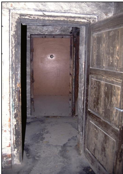
Abbildung 48: Blick von innen in die Luftschleuse des ehemaligen SS-Luftschutzbunkers, mit der Luftschutztür im Hintergrund.
