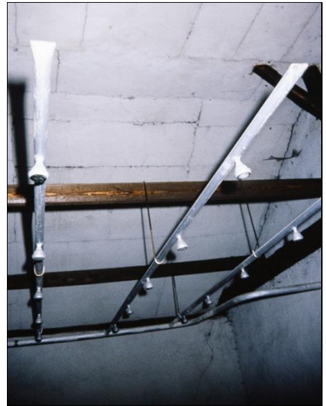
Abbildung 43: Wasserrohrsystem mit Duschköpfen im Entwesungstrakt des Bauwerks 5b. Diese Wasserrohre haben keinerlei Anschluss, sie enden in den Entlüftungsöffnungen. Siehe Abbildung 42.
