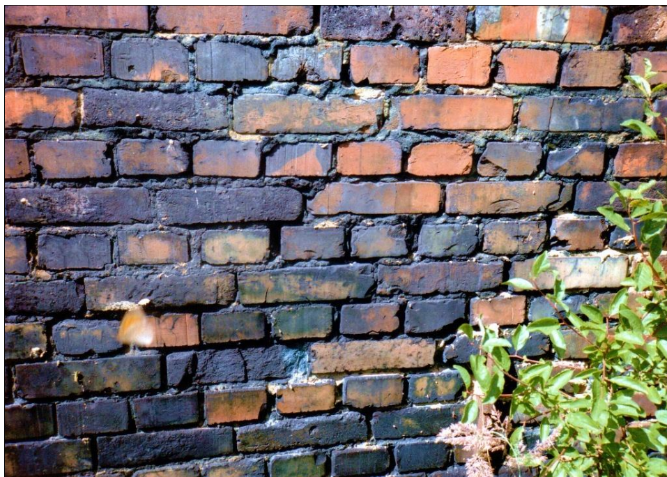
Abbildung 166: Entwesungstrakt des Bauwerks 5b, Südmauer, in der Nähe der Eingangstür gemachte Nahaufnahme mit intensiver Verfärbung. (© C. Mattogno 1992)
